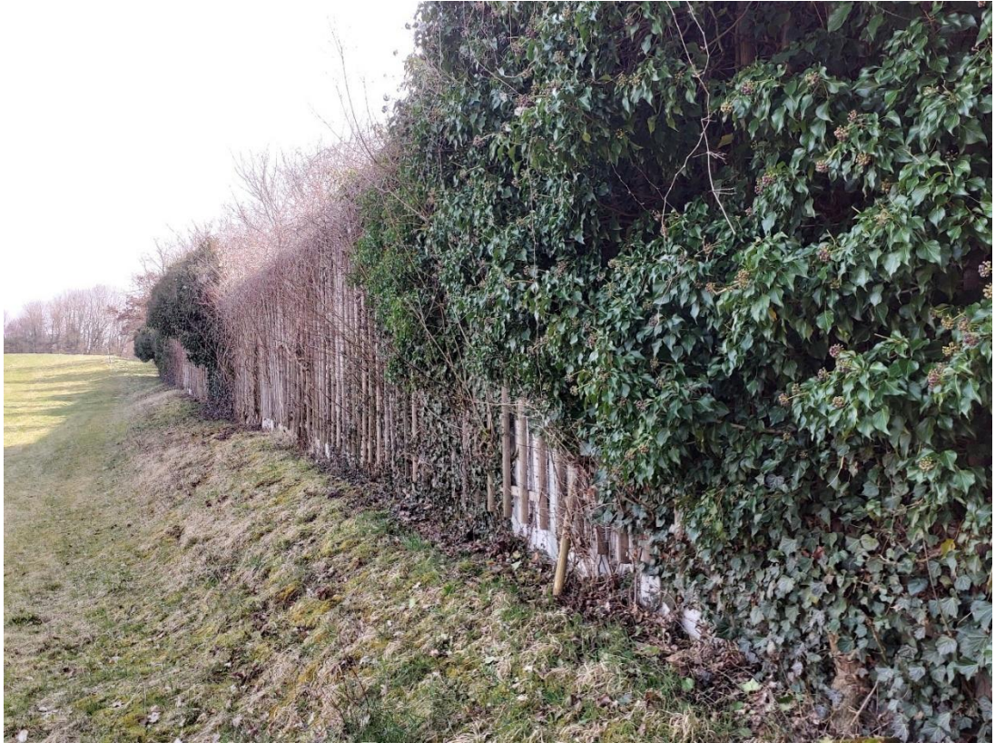
Abbildung 11: Efeubewuchs an der Lärmschutzwand Richtung Norden © PV München 03/2026
