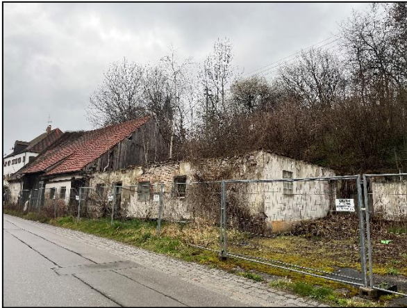
Bild 03: Teils stark verfallene Nebengebäude im Südwesten des UG
