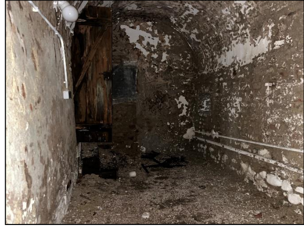
Bild 10: Inneneindruck eines weiteren Bereichs des Lagerkellers unter dem Hauptgebäude mit tiefen Spalten im Ziegelwerk
