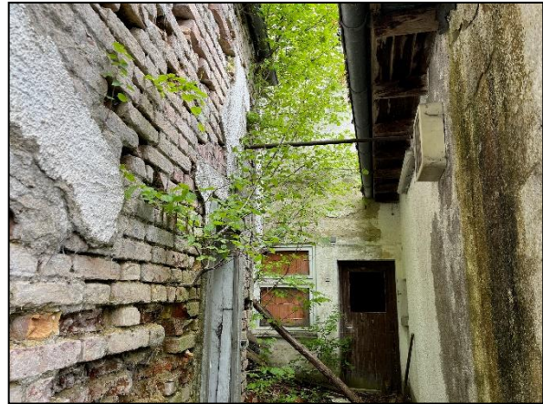
Bild 04: Bereich westlich des Hauptgebäudes mit tiefen Spalten im Ziegelmauerwerk sowie freien Einflugmöglichkeiten in den Kellerbereich
