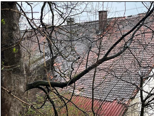
Bild 05: Dach im Nordwesten des Hauptgebäudes mit diversen fehlenden Ziegeln und Teileinstürzen
