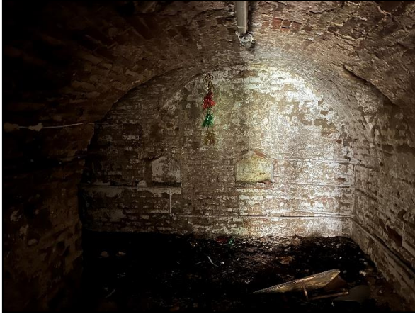
Bild 09: Inneneindruck eines Lagerkellers unter dem Hauptgebäude mit tiefen Spalten im Ziegelwerk
